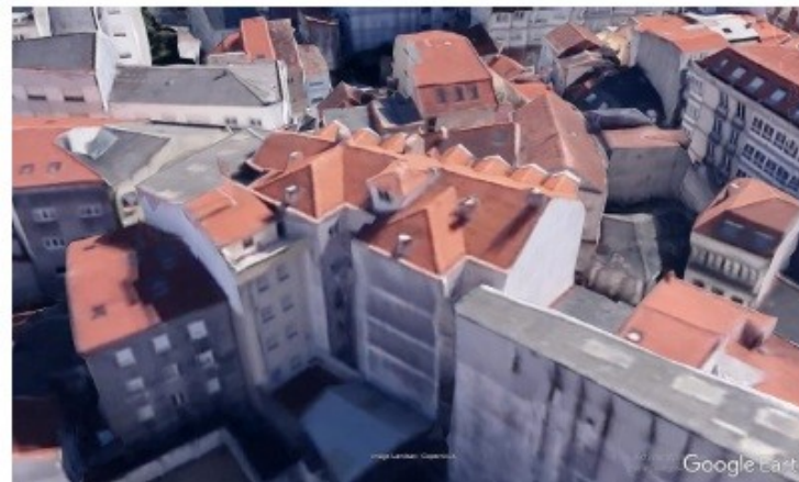
Fotografía 3_imaxes do estado inicial da cuberta aportadas na denuncia (RE.: 202200020636)
